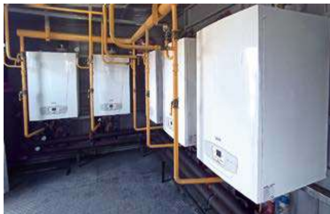
Детский сад, г. Майкоп Общая мощность котельной - 500 кВт
