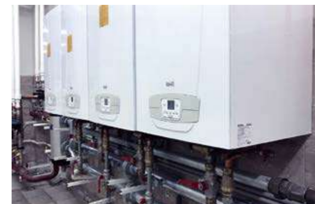
Общежитие, г. Усть-Луга Общая мощность котельной - 300 кВт
