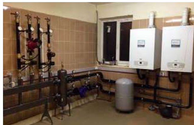
Автосервис, г. Москва Общая мощность котельной - 300 кВт
