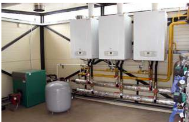
Детский сад, г. Калининград Общая мощность котельной - 300 кВт
