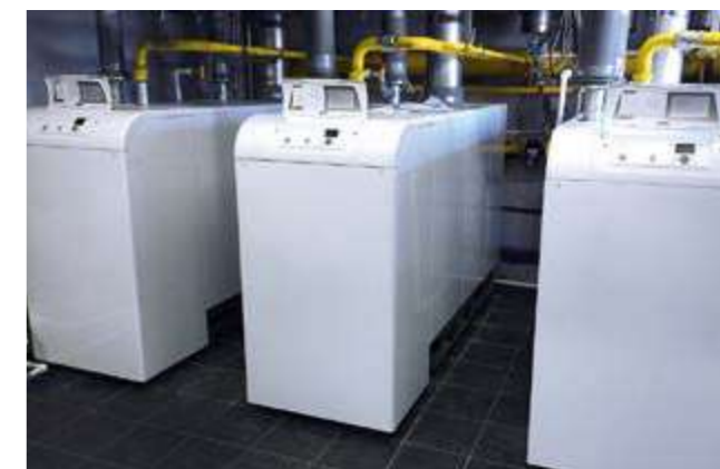
Фитнес-центр «Мой спорт Белоозерский» Общая мощность котельной — 1,5 МВт
